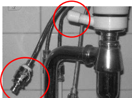
Kuva 3. Pyykinpesukoneen imusuoja ja muovitulppa
